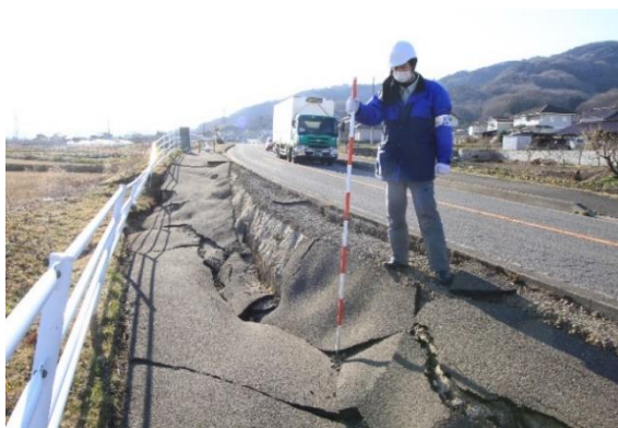
道路崩落状況（下成田地区）
