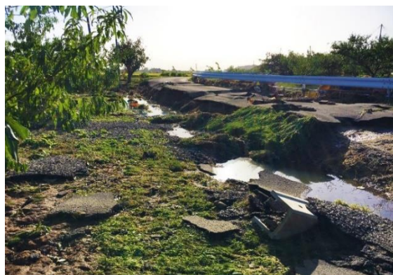
西根堰溢水状況（北沢地区）
