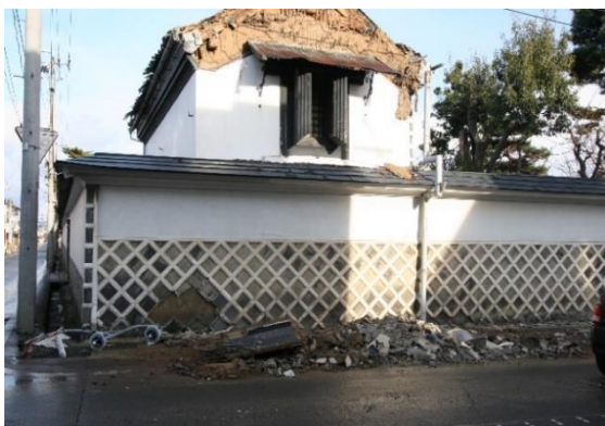
倉庫崩落状況（北町地区）
