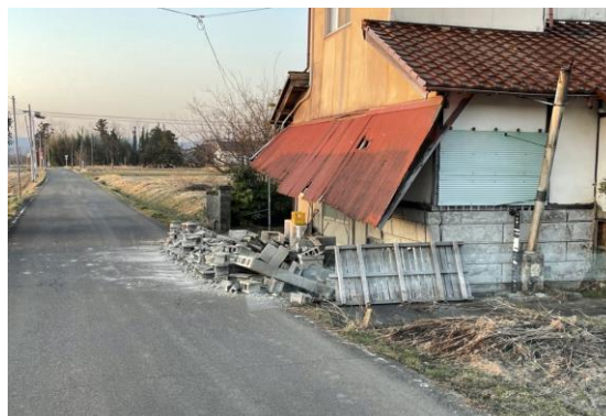
ブロック塀倒壊状況（下高屋地区）
