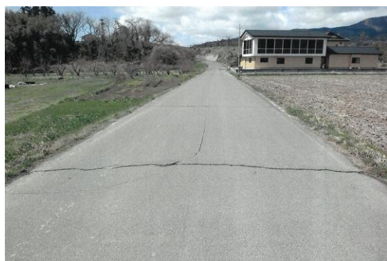
町道被災状況（北沢地区）
