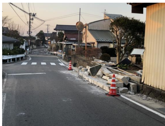
石塀倒壊状況（田町地区）
