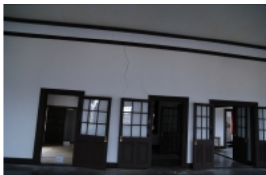
2月14日福島県沖地震により、旧伊達郡役所が再び被災
