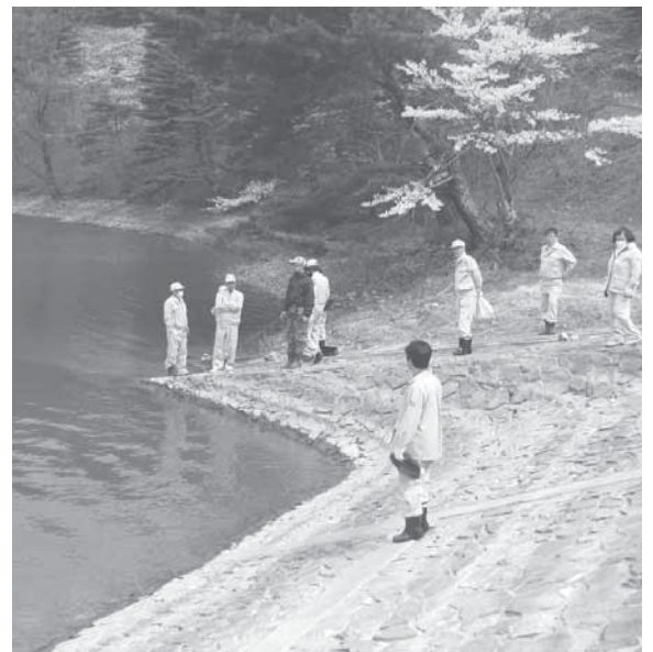
▲半田沼の亀裂調査
