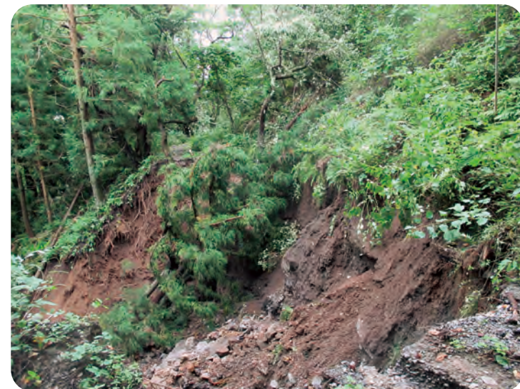
平成27年9月大雨による越水土砂崩壊現場「9/8大雨による宮沢地区災害状況」より
