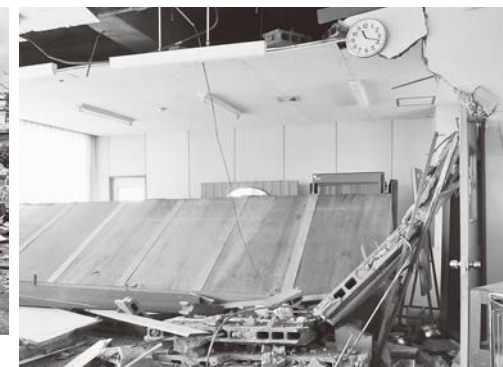
伊達崎小 特別教室の天井が崩れた
