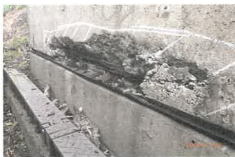
008. 古沢迦堂橋：PCラーメン橋 (橋長：42.25m、1973年竣工) 橋脚垂直材の鉄筋露出 ※露出鉄筋の断面欠損により、耐荷力の低下が推測される。(迂回路有り)
