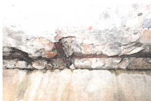
081.1165-1：RC中実床版橋 (橋長：4.50m、1967年竣功) 床版下面の著しい鉄筋露出 ※露出鉄筋の著しい腐食により、耐荷力の低下が推測される。(迂回路有り)
