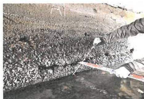
102.2027-1：RC中実床版橋 (橋長：4.15m、1965年竣功) 下部工の洗堀 ※露出鉄筋の著しい腐食により、耐荷力の低下が推測される。(迂回路有り)
