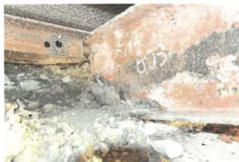
141.4033-1: 鋼H桁橋 (橋長: 4.80m、1965年竣工) 主桁の板厚減少を伴う腐食 ※支点上での板厚減少は耐力力の低下が推測される。(迂回路有り)
