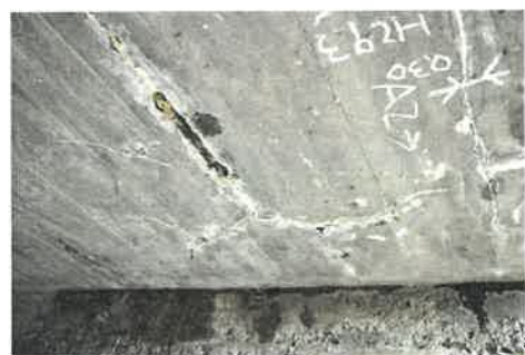
096.1238-2小峯橋: RC中実床版橋 (橋長: 2.00m、1987年竣工) 床版下面の遊離石灰を伴った二方向ひびわれ ※耐力力の低下が推測される。 (迂回路有り)
