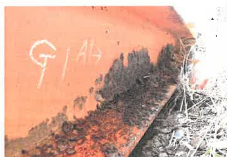
070.1084-3：鋼H桁橋 (橋長：7.10m、1978年竣功) 主桁の板厚減少を伴う腐食 ※支点上での板厚減少は、耐荷力の低下が推測される。(迂回路有り)
