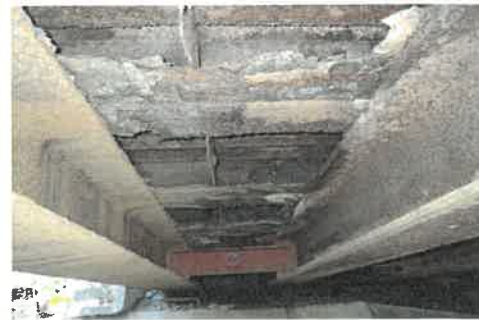
146.4117-1: 鋼H桁橋 (橋長: 7.50m、1965年竣工) 主桁の板厚減少を伴う腐食 ※広範囲の板厚減少は耐力力の低下が推測される。(迂回路有り)
