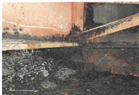
069.1084-2: 鋼H桁橋 (橋長: 14.10m、1978年竣工) 主桁の板厚減少を伴う腐食 ※支点上での板厚減少は耐力力の低下が推測される。(迂回路有り)
