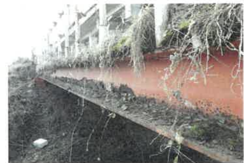
073.1086-4: 鋼H桁橋 (橋長: 12.00m、1978年竣工) 主桁の板厚減少を伴う腐食 ※下フランジの板厚減少は耐力力の低下が推測される。(迂回路有り)
