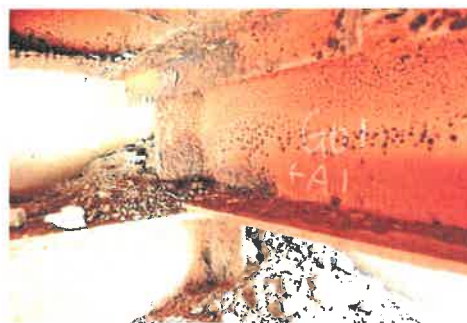
151.4124-2：鋼H桁橋 (橋長：4.60m、1979年竣功) 主桁の板厚減少を伴う腐食 ※板厚減少により、耐荷力の低下が推測される。(迂回路有り)
