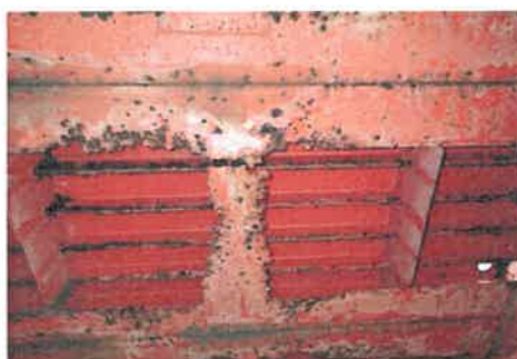
152.4124-3：鋼H桁橋 (橋長：9.30m、1979年竣功) 鋼床版の孔食を伴う腐食 ※板厚減少により、耐荷力の低下が推測される。(迂回路有り)
