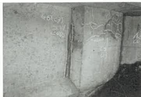
019. 猪之馬場橋: PCT桁橋 (橋長: 20.30m、1981年竣工) PC定着部の錆汁を伴った遊離石灰の析出 ※内部鋼材の腐食の進行は、耐力力の低下が推測される。(迂回路有り)
