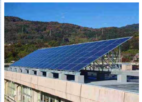
太陽光発電・蓄電装置が設置された醸芳小校舎
