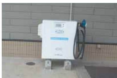
災害時、電気自動車の電気を供給できるEVパワーステーション(やすらぎ園・イコーゼ!に設置)
