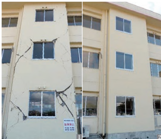
1_ 地震発生直後の水飲み場付近の被害の様子 2_ 災害復旧工事により、改良・補強された水飲み場付近
