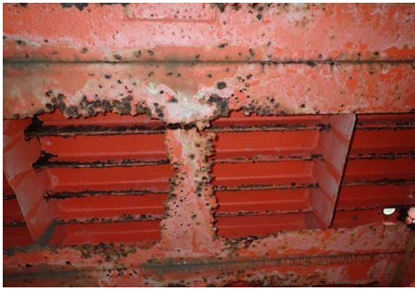
152. 4124-3 : 鋼H桁橋 (橋長 : 9.30m、1979年竣工) 鋼床版の孔食を伴う腐食 ※板厚減少により、耐荷力の低下が推測される。(迂回路有り)
