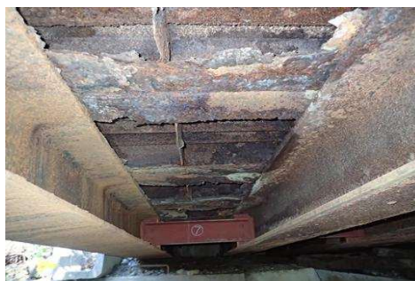
146. 4117-1 : 鋼H桁橋 (橋長 : 7.50m、1965年竣工) 主桁の板厚減少を伴う腐食 ※広範囲の板厚減少は耐荷力の低下が推測される。(迂回路有り)
