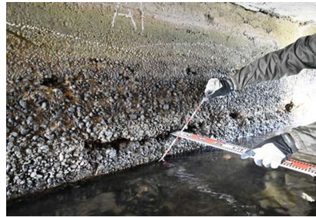
102. 2027-1 : RC中実床版橋 (橋長 : 4.15m、1965年竣工) 下部工の洗掘 ※露出鉄筋の著しい腐食により、耐荷力の低下が推測される。(迂回路有り)
