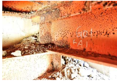
151. 4124-2 : 鋼H桁橋 (橋長 : 4.60m、1979年竣工) 主桁の板厚減少を伴う腐食 ※板厚減少により、耐荷力の低下が推測される。(迂回路有り)
