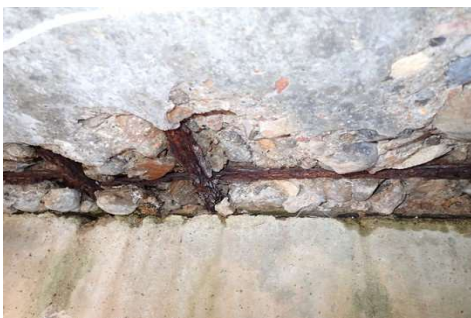
081. 1165-1 : RC中実床版橋 (橋長 : 4.50m、1967年竣工) 床版下面の著しい鉄筋露出 ※露出鉄筋の著しい腐食により、耐荷力の低下が推測される。(迂回路有り)
