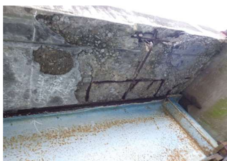
018. 西北沢橋：鋼H桁橋 (橋長：17.580m、1968年竣工) 床版下面の鉄筋露出 ※露出鉄筋の著しい腐食により、耐荷力の低下が推測される。(迂回路有り)
