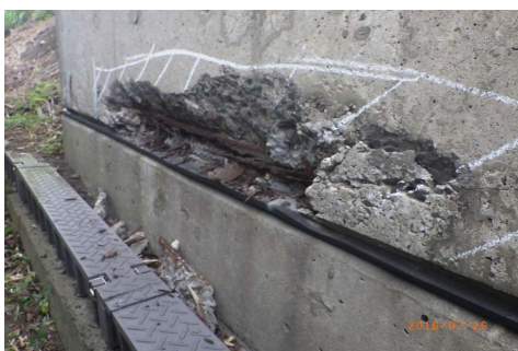
008. 古釈迦堂橋：PCラーメン橋 (橋長：42.25m、1973年竣工) 橋脚垂直材の鉄筋露出 ※露出鉄筋の断面欠損により、耐荷力の低下が推測される。(迂回路有り)
