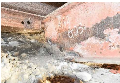
141. 4033-1 : 鋼H桁橋 (橋長 : 4.80m、1965年竣工) 主桁の板厚減少を伴う腐食 ※支点上での板厚減少は耐荷力の低下が推測される。(迂回路有り)
