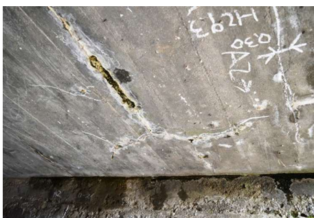
096. 1238-2小峯橋 : RC中実床版橋 (橋長 : 2.00m、1987年竣工) 床版下面の遊離石灰を伴った二方向ひびわれ ※耐荷力の低下が推測される。 (迂回路有り)
