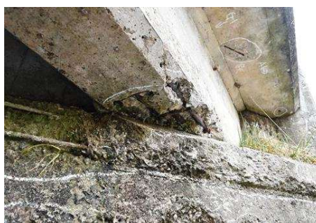
030. 102-1大澤橋：RCT桁橋 (橋長：8.90m、1933年竣工) 主桁下面及び側面の鉄筋露出 ※露出鉄筋の著しい腐食により、耐荷力の低下が推測される。(迂回路有り)
