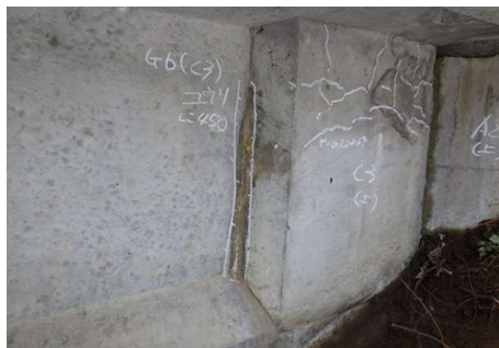
019. 猪之馬場橋 : PCT桁橋 (橋長 : 20.30m、1981年竣工) PC定着部の錆汁を伴った遊離石灰の析出 ※内部鋼材の腐食の進行は、耐荷力の低下が推測される。(迂回路有り)
