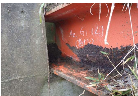
0072. 1086-3：鋼H桁橋 (橋長：12.00m、1978年竣工) 主桁の板厚減少を伴う腐食 ※板厚減少により、耐荷力の低下が推測される。(迂回路有り)
