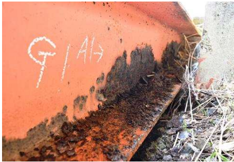
070. 1084-3 : 鋼H桁橋 (橋長 : 7.10m、1978年竣工) 主桁の板厚減少を伴う腐食 ※支点上での板厚減少は、耐荷力の低下が推測される。(迂回路有り)
